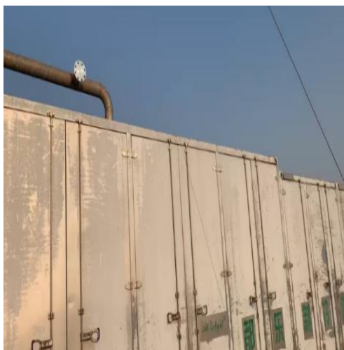
油气回收装置
