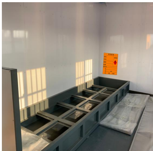
危险废物暂存间内部标识牌
