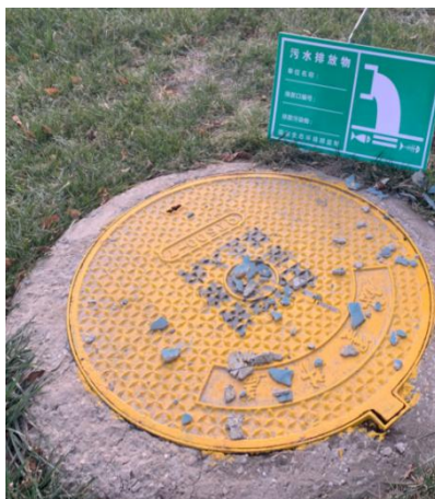
污水排放口标识牌
