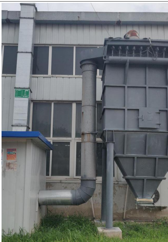
排气筒 P1 与布袋除尘器
