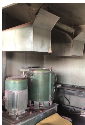
高速混合废气收集
